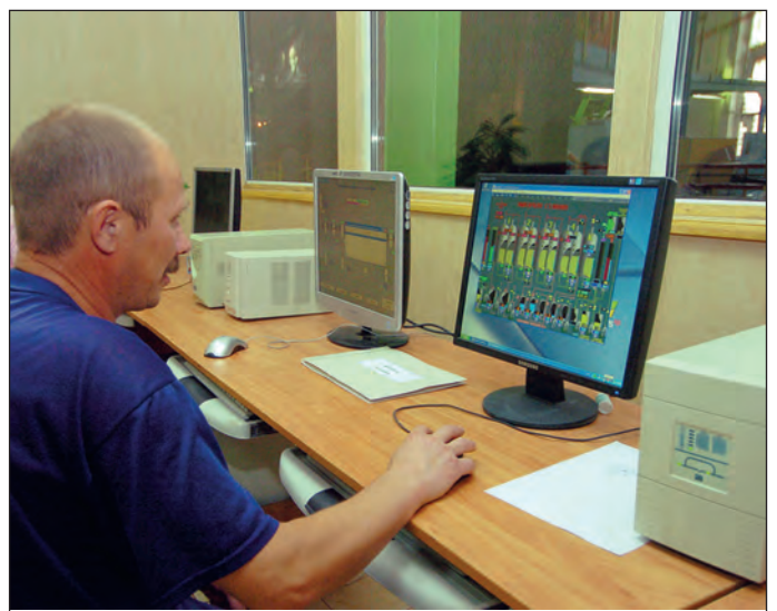
Главный щит управления заводом. Оператор выпарной станции Н.А. Озеров
