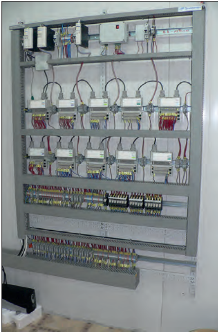
Рис. 3. Контроллерная панель управления
