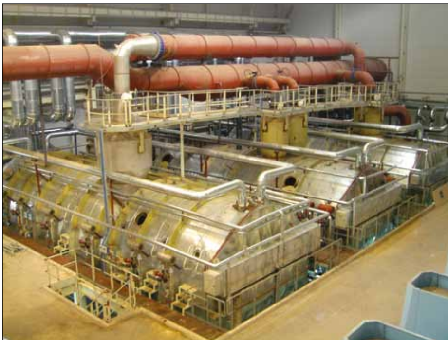
Рис. 4. Общий вид площадки с установленными ВАНД конструкции Fives Cail для утфелей I, II и III кристаллизации (сахарный завод Богазлян, Турция)
