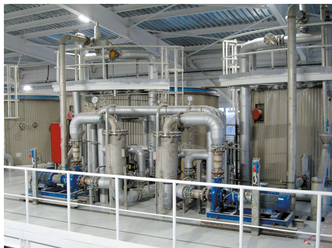
Рис. 7. Трубопроводная обвязка в отделении дешугаризации мелассы, ОАО «Знаменский сахарный завод»
