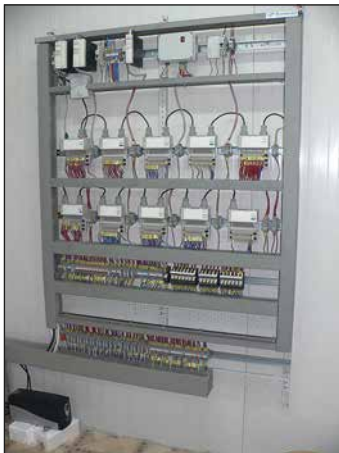
Рис. 2. Контроллерная панель управления
