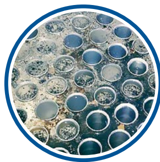
Теплообменник до очистки
