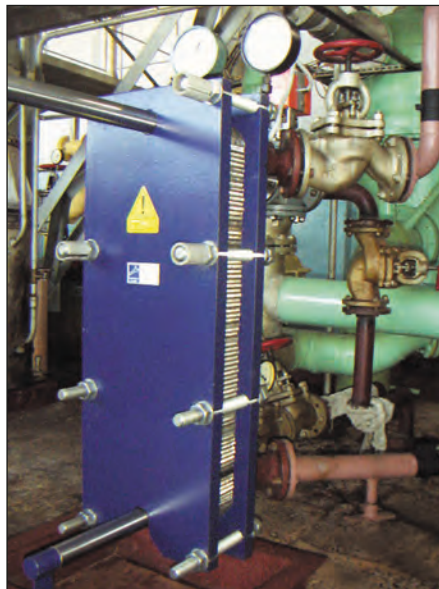
Рис. 2. Пластинчатый теплообменник «ГЕА Машимпэкс» на ОАО «Гиркубс» (Гулькевичский сахарный завод)
