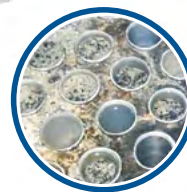
Теплообменник до очистки
