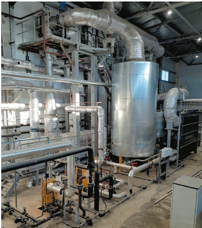
Рис. 5. Многокорпусная выпарная установка
